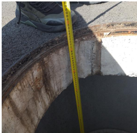
Camin racord canalizare stradala
